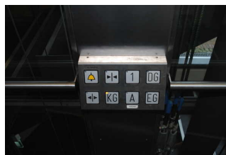
Aufzug im Rathaus, Bedienelement
