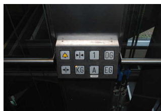
Aufzug im Rathaus, Bedienelement
