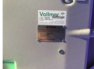
Treppenlift zum 1. OG
