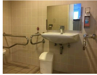
Öffentliches WC im Foyer des Kurmittelhaus
