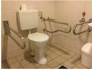
Öffentliches WC im Foyer des Kurmittelhaus
