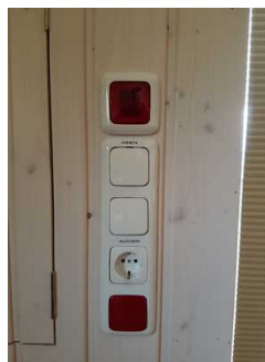
Schlaf-, Wohnraum Notfallalarm an der Eingangstür
