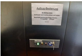
Aufzug zu WCs und Halle Innenraum
