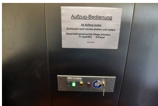
Aufzug zu WCs und Halle Innenraum
