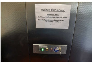
Aufzug zu WCs und Halle Innenraum
