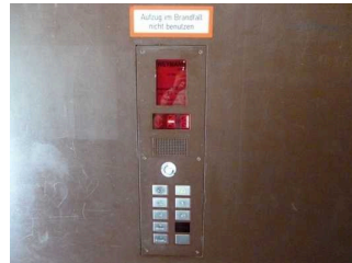
Bedienelemente Fahrstuhl Gebäude Dauerausstellung
