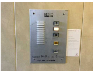
Aufzug zum Foyer
