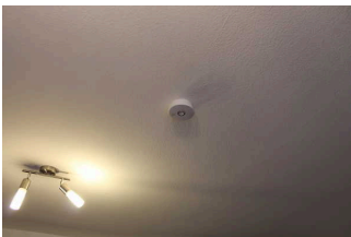
Rauchmelder sind im Wohnbereich und Schlafrum installiert.
