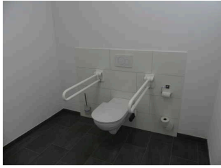
WC mit Haltegriffen heruntergeklappt
