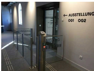
Zugangskontrolle zwischen Foyer und Treppenhaus
