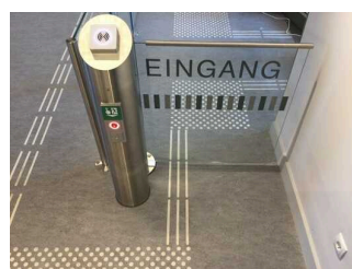
Zugangskontrolle zwischen Foyer und Treppenhaus
