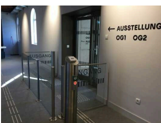
Zugangskontrolle zwischen Foyer und Treppenhaus
