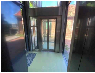
Aufzug EG bis 3. OG
