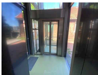
Aufzug EG bis 3. OG
