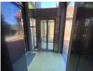
Aufzug EG bis 3. OG
