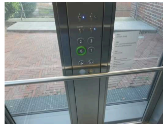
Bedienelemente Fahrstuhl innen
