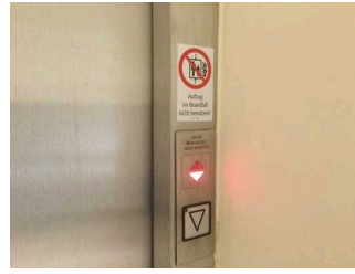
Aufzug zwischen Wellnessbereich und Saunabereich
