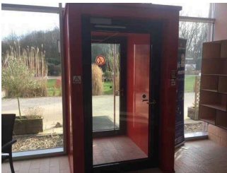
Innentür zur Schleuse zwischen Innenbereich und Außenbereich
