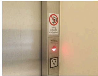
Aufzug zwischen Wellnessbereich und Saunabereich
