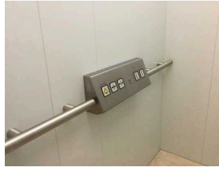
Aufzug zwischen Wellnessbereich und Saunabereich
