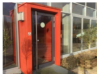
Außentür zur Schleuse zwischen Innenbereich und Außenbereich
