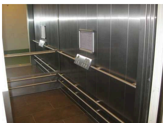
Aufzugskabine und die horizontal angeordneten Bedienelemente
