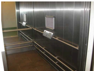
Aufzugskabine und die horizontal angeordneten Bedienelemente
