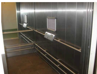
Aufzugskabine und die horizontal angeordneten Bedienelemente
