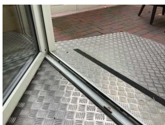
Rampe über Türschwelle
