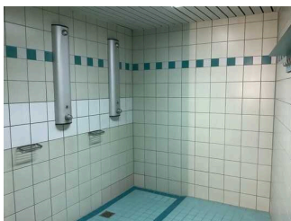
Duschen Damen und Herren im Saunabereich
