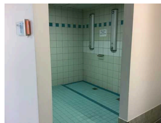
Duschen Damen und Herren im Saunabereich
