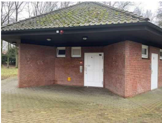
Öffentliches WC am Parkplatz P2
