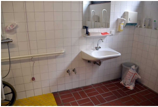
Sanitärraum in Freibad- Umkleidekabine
