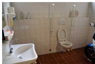
Sanitärraum in Freibad- Umkleidekabine
