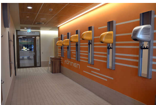
Flur zu Umkleiden
