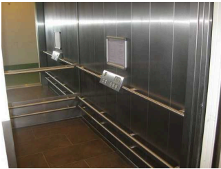
Aufzugskabine und die horizontal angeordneten Bedienelemente
