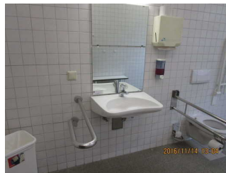
Waschbecken Sanitärraum für Menschen mit Behinderung
