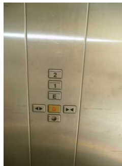
Aufzug zu den Tribünen in der kleinen EWE Arena
