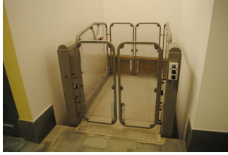
Hublift auf dem Weg zwischen Thalassoebene und Wasserebene
