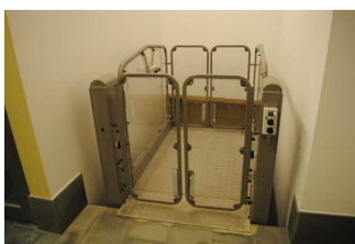
Hublift auf dem Weg zwischen Thalassoebene und Wasserebene
