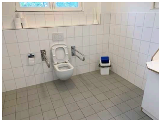
Öffentliches WC im Heidedorf (gegenüber Gebäude H1)
