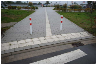
Weg außen vom Parkplatz für Menschen mit Behinderung und Bushaltestelle zum Eingang
