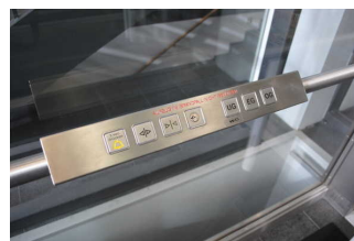
Aufzug UG/ EG/1.OG
