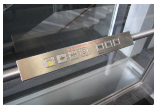
Aufzug UG/ EG/1.OG
