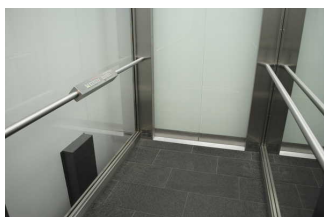
Aufzug UG/ EG/1.OG
