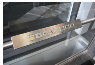
Aufzug UG/ EG/1.OG
