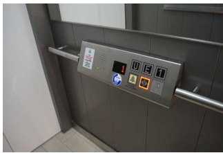
Aufzug zwischen Foyer Eingang und DünenSpa im OG
